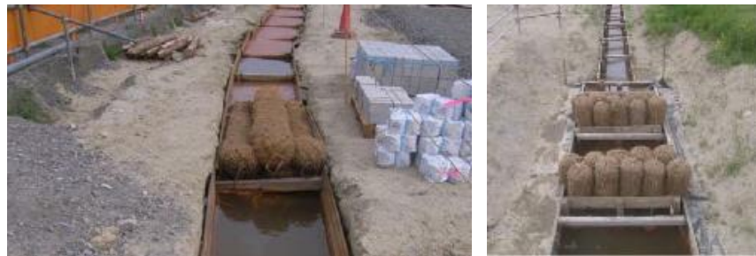
濁水濾過フィルターの設置状況
